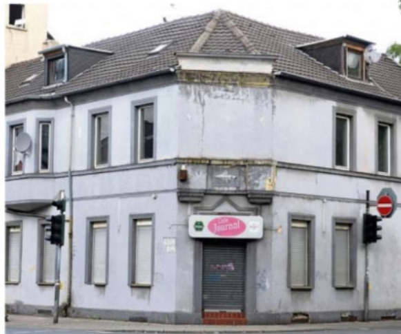
Seine Lage ist markant, sein Zustand bescheiden. Das Eckgebäude an der Grenzstraße/Lothringer Straße trägt noch immer das Schild vom „Café Journal“.
